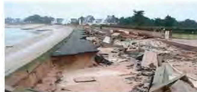
Rupture d'ouvrage de protection à Gâvres - Mars 2008 - Photo DDTM 56 (Erwan le Cornec GEOS)
